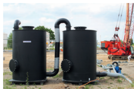
▲ Luftabsaugung und -reinigung
